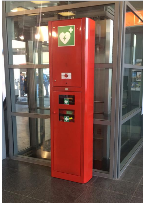
Beispiel: Notfallterminal mit Sprech- verbindung, Notfalldepot und AED
