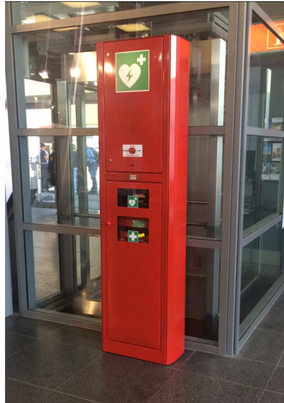
Beispiel: Notfallterminal mit Sprechverbindung, Notfalldepot und AED
